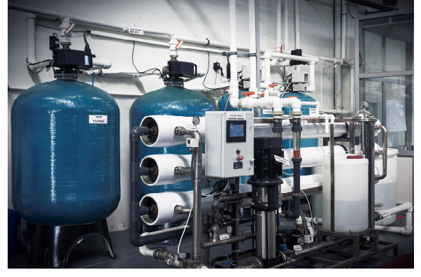
Çerkezköy Arıtma Tesisimiz (2020)
